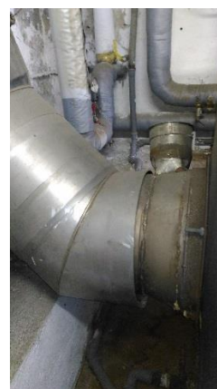
Figura 4.12 - Particolare della caldaia
