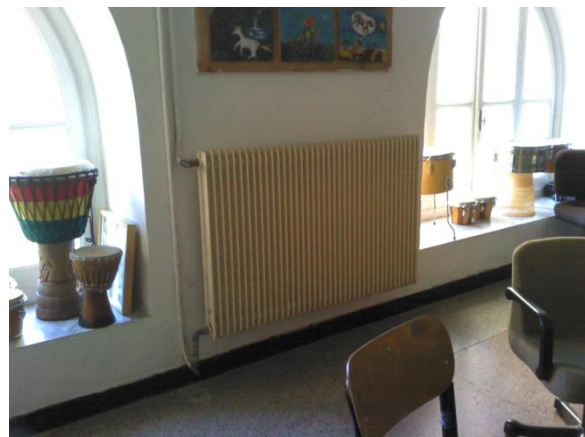
Figura 4.8 - Particolare dei radiatori
