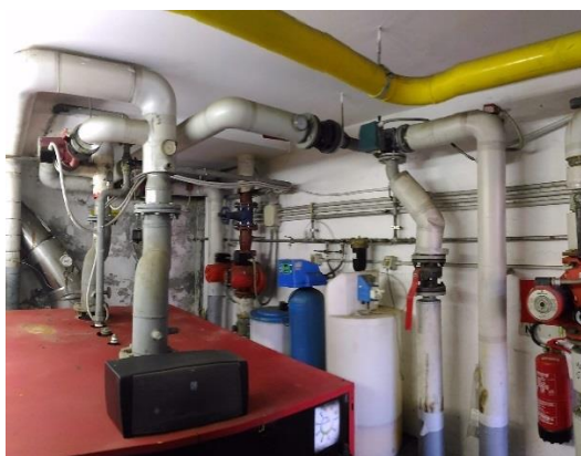
Figura 4.11 - Particolare della caldaia
