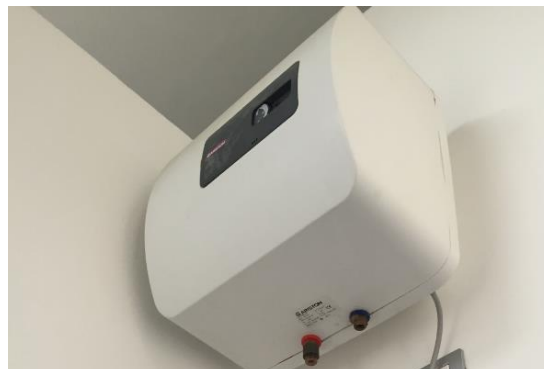
Figura 4.13 - Particolare di un boiler elettrico per la produzione di acqua calda sanitaria
